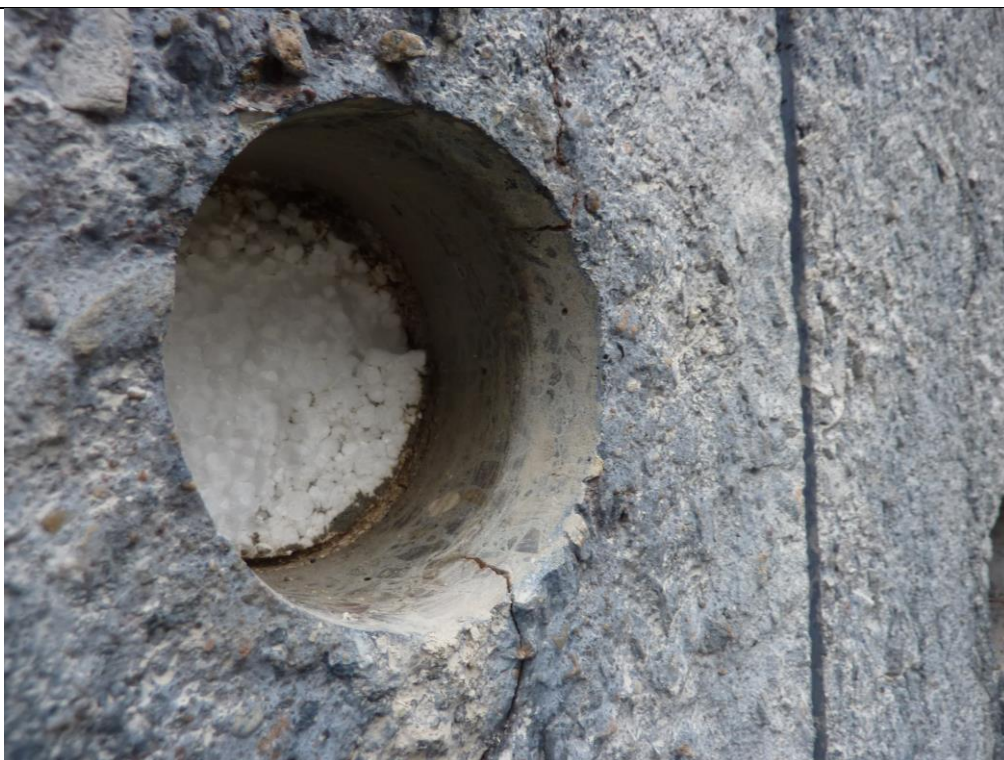
Foto 23: (P1180668.JPG) Revnen går halvt ind i forpladen.
