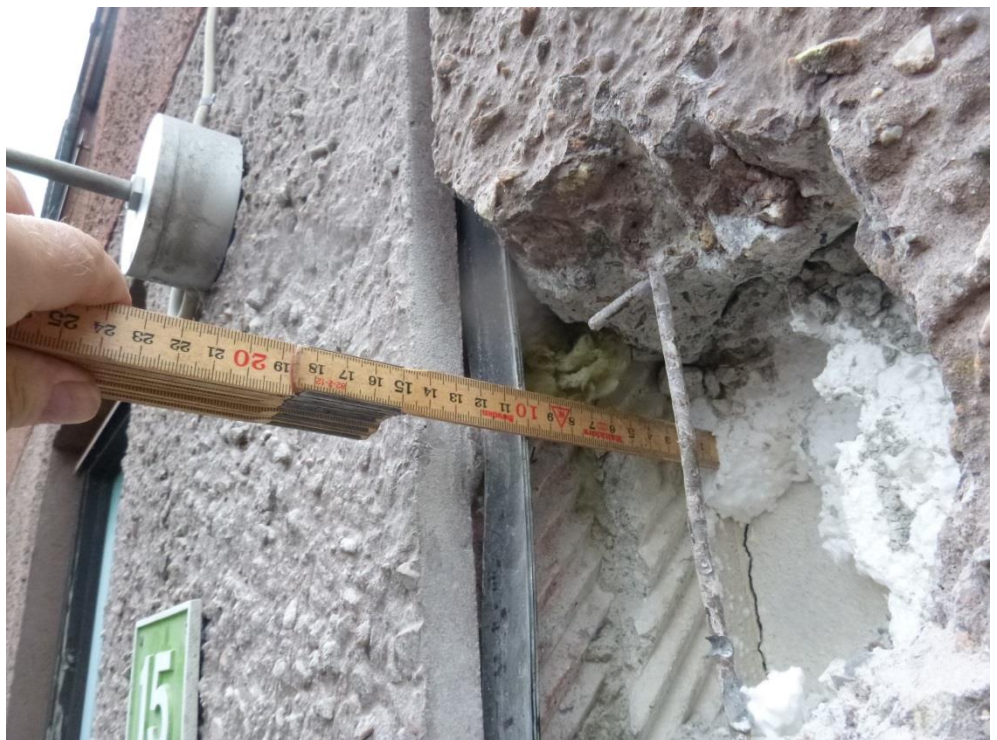
Lodret samling mellem to elementer: Ca. 140 mm inde er der 20 mm polystyrol bag forpladens tykke del. Fugeudstøbning er ført forbi isoleringen, så isoleringen er brudt i fugens tykkelse. Korrekt ud-
