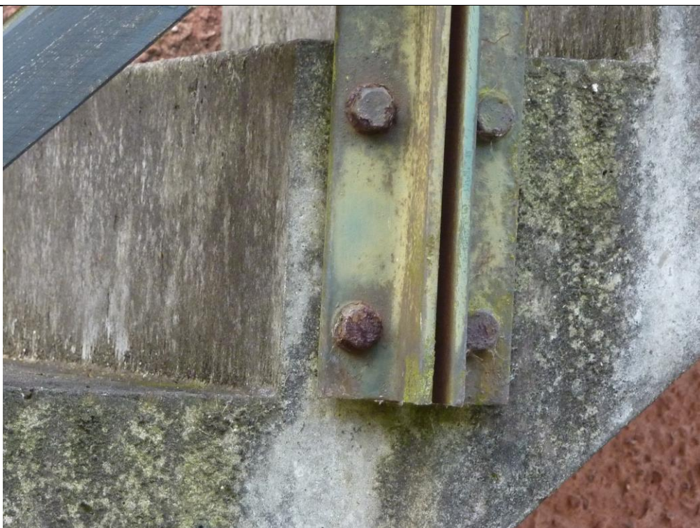
Foto 16: (P1180606.JPG) Boltefastgørelser er meget rustangrebet.
