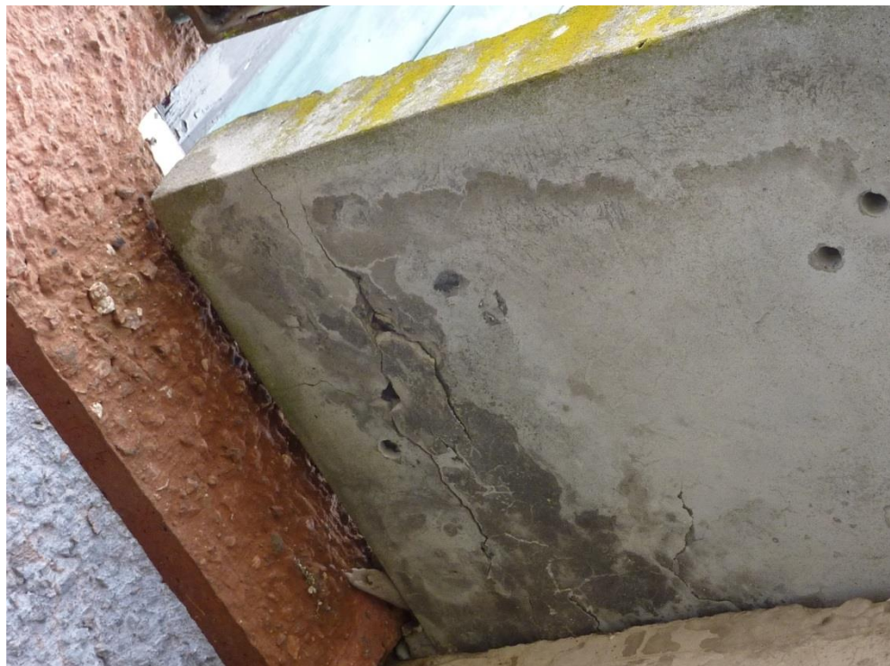
Eksempel på skade på underside af repos.
