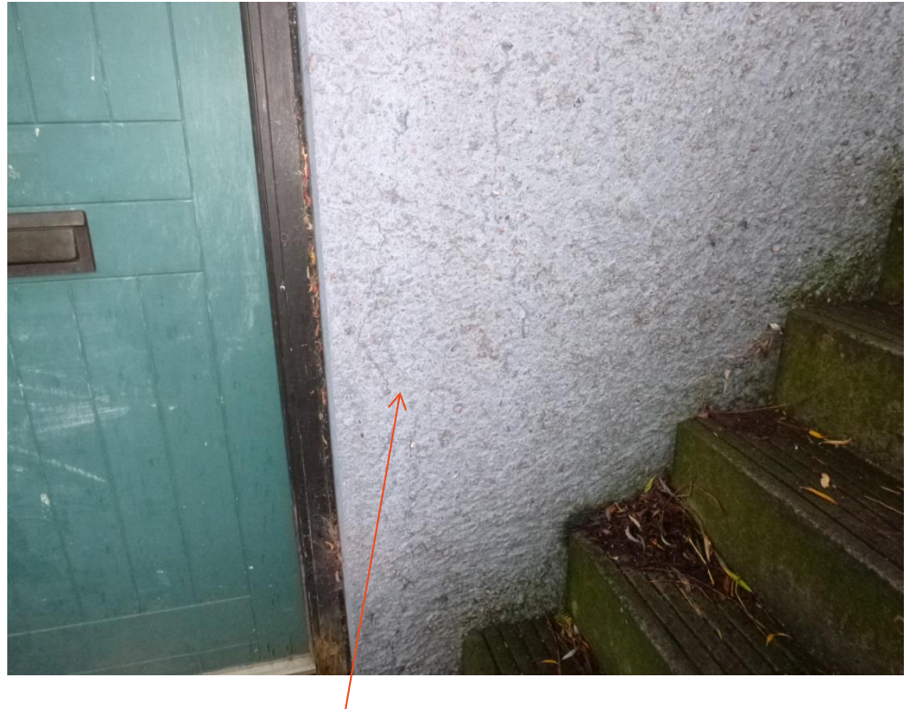
Hjortelængen 10. Revnedannelser i blå facadeelement
